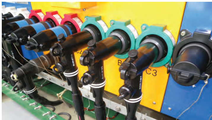
¿Pruebas de Intercambiabilidad? Instalación de productos Chardon y sus competidores en campo.
